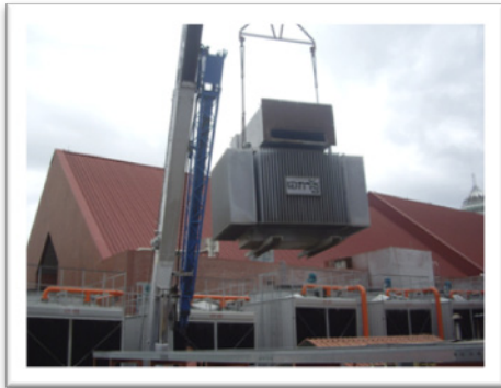
หม้อแปลงไฟฟ้า TR3 (เก่า) 1,250 kVA
