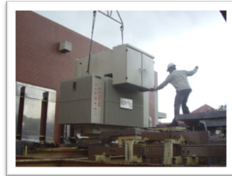
หม้อแปลงไฟฟ้า TR3 (ใหม่) 2,000 kVA
